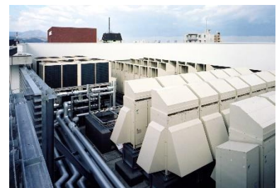
当院の空調機
